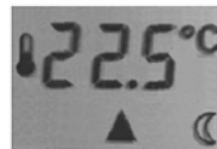
Anzeige im Energiesparbetrieb
